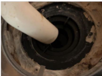
Synlig membran i sluket.
