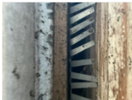
Synlig musebånd som er besiktiget ved inngang.
