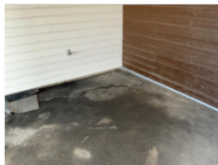
Noe fall mot såle/yttervegg ved carport.
