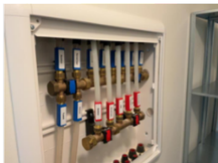
Rørskap på vaskerommet.
