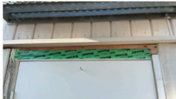
Ikke tettet rundt dør i 1. etasje
