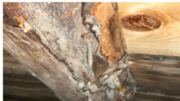
Råte i deler av konstruksjonen
