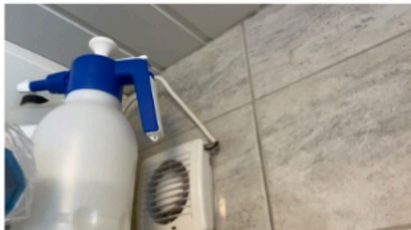
Manglende isolering av ledning på vifte
