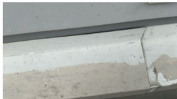
Beslag undr terrassedøren er ikke montert riktig.
